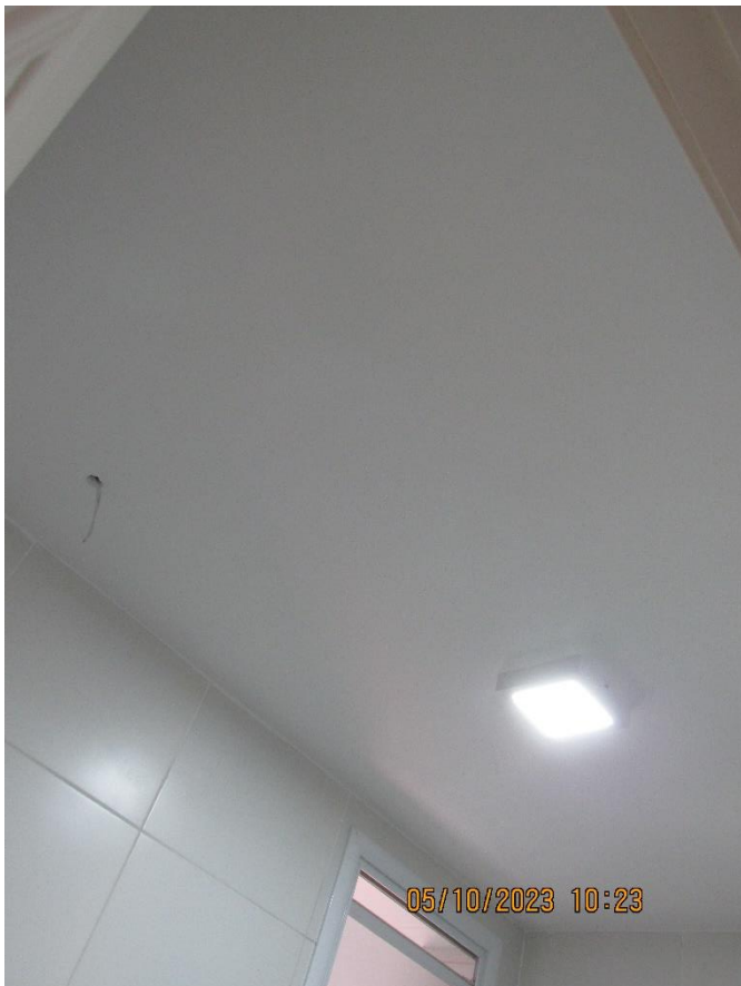
Teto/Banheiro Social (desgaste)
