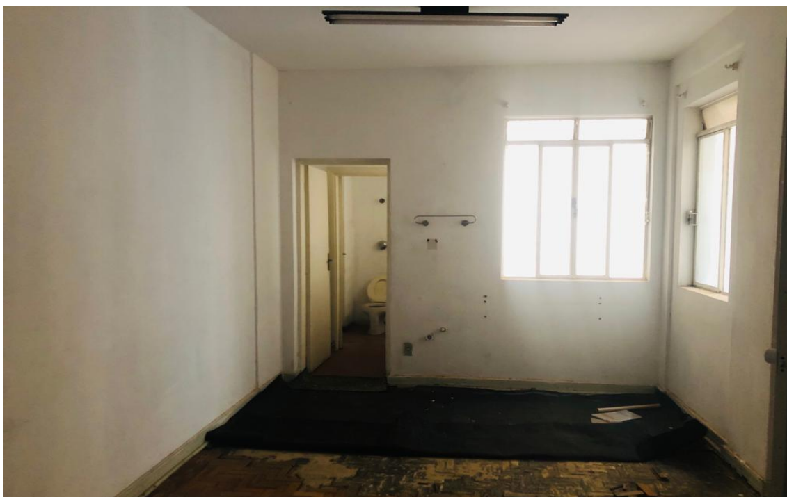
Visão da sala – necessita de reparos
