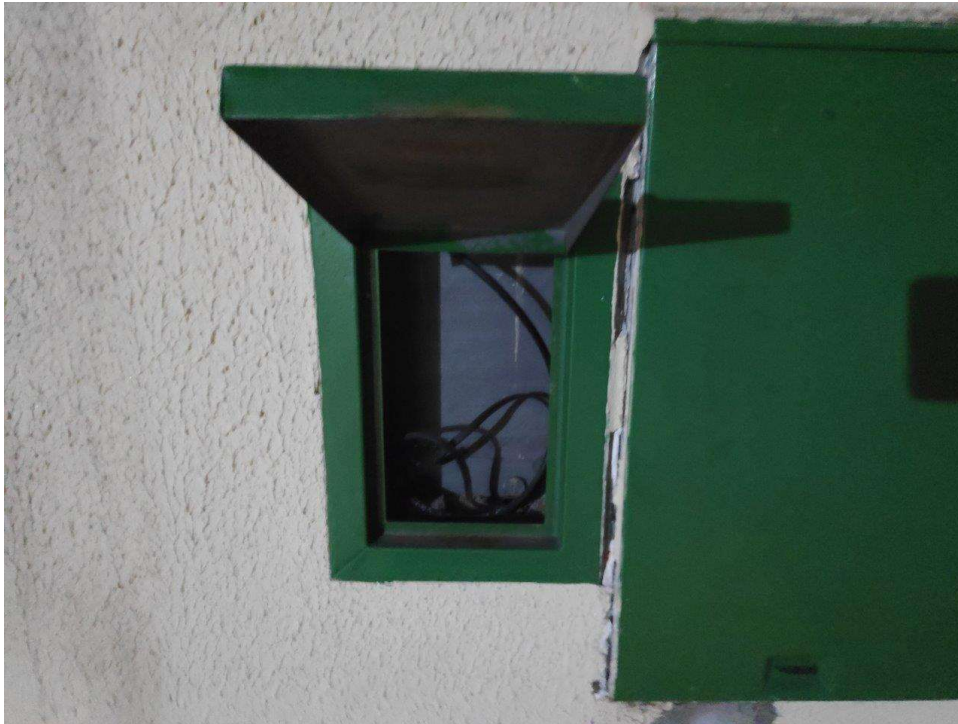
Figura 31 – Entrada telefonia e rede
