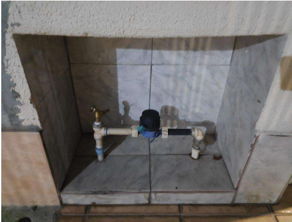
Figura 29 – Medidor de água concessionária
