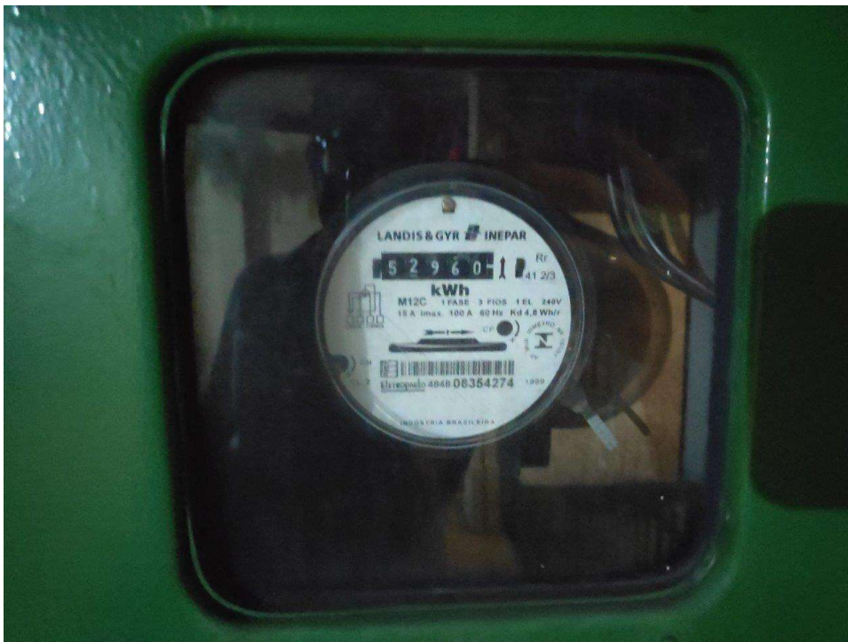
Figura 30 – Medidor de energia concessionária
