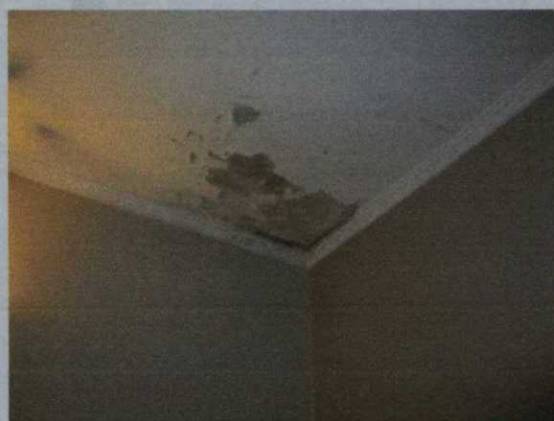
Figura 13 – Avaria teto sala de estar
