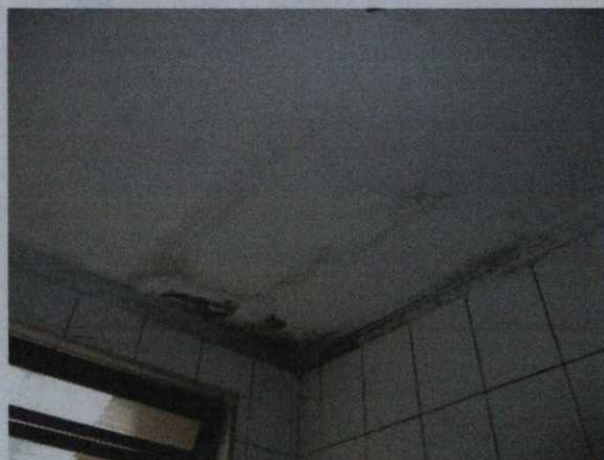
Figura 19 – Umidade – Teto banheiro
